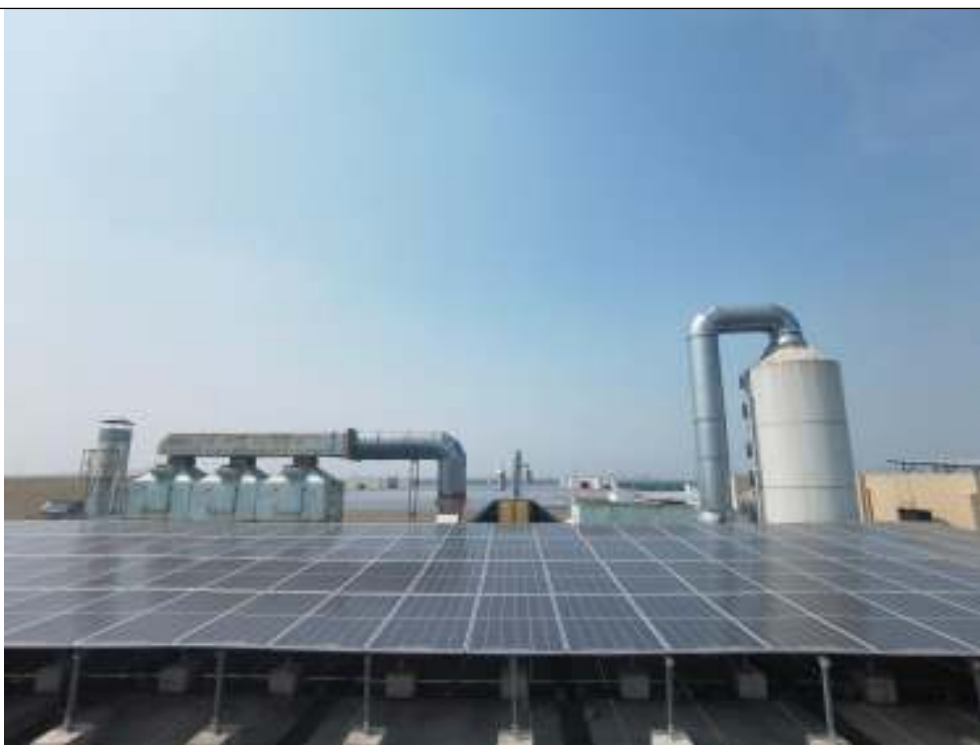
印刷废气处理设施
