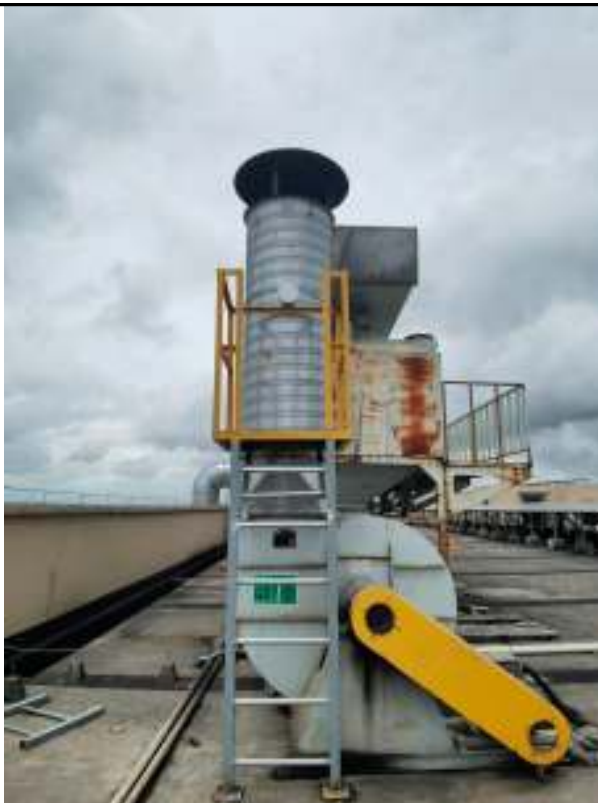
贴合废气处理设施
