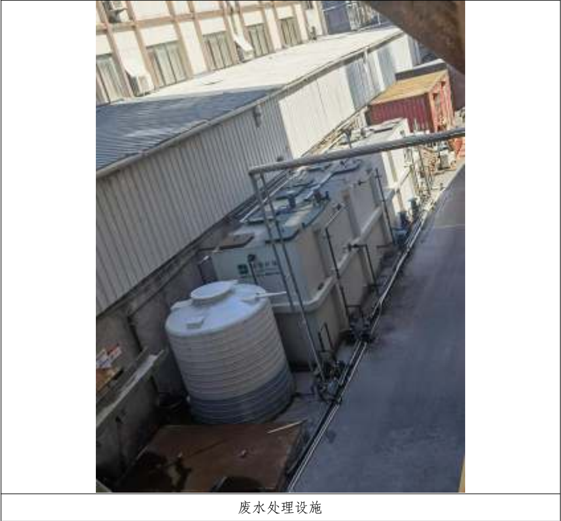
图 4-2 废水处理设施照片
