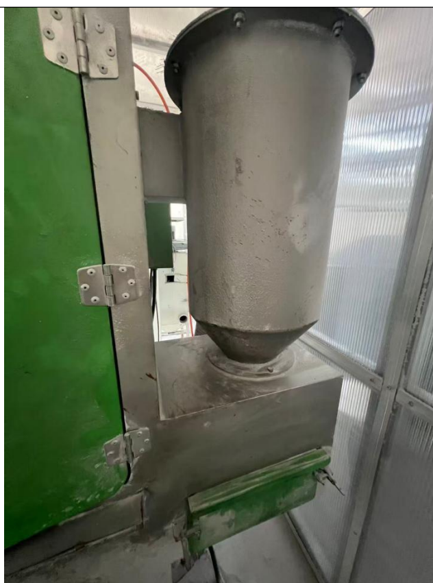
喷砂机设备自带过滤除尘器
