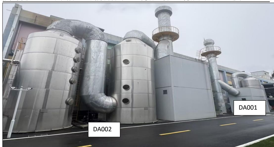
2套二级水喷淋处理设施
