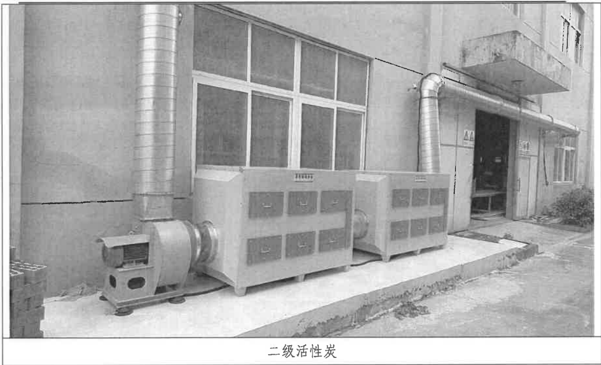
图 4-3 废气治理现场相关照片
