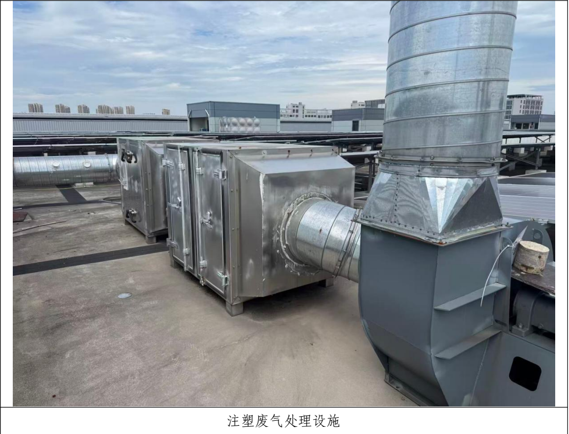
图 4-4 废气处理设施图
