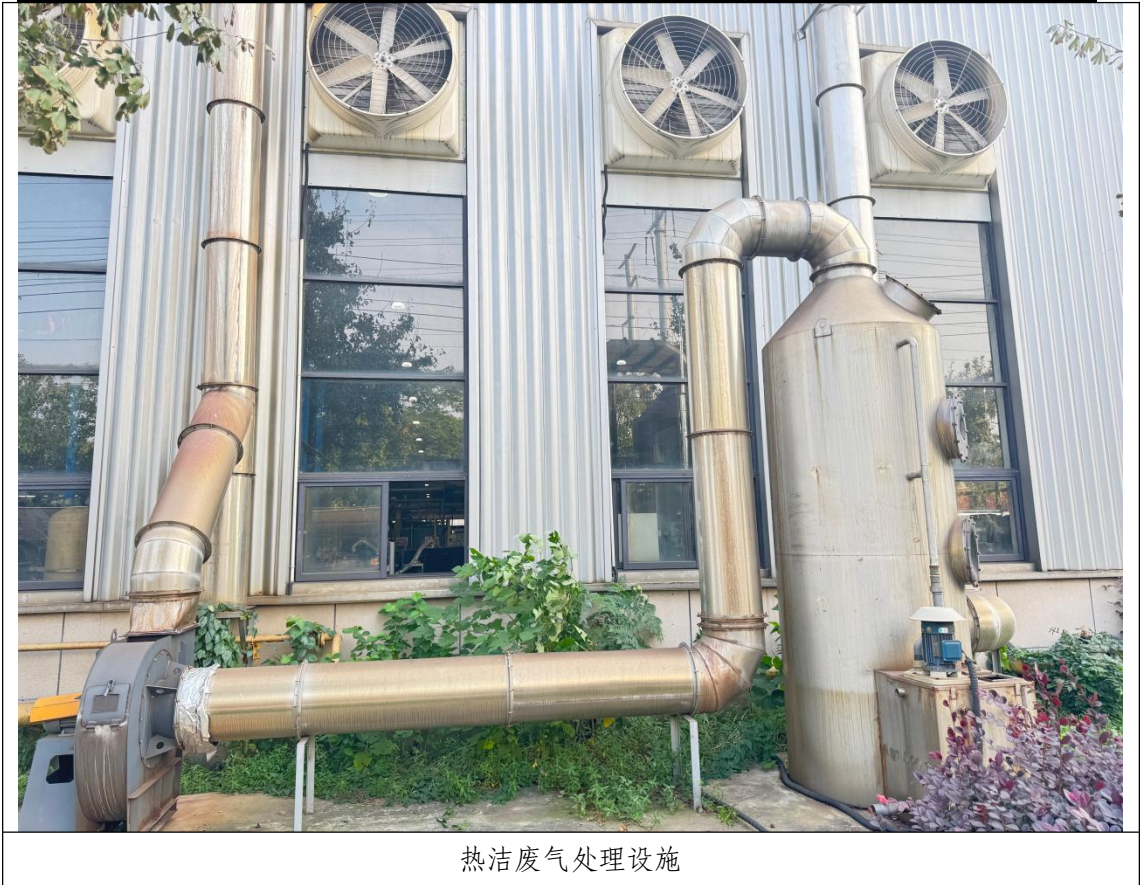
图 4-4 废气处理设施照片
