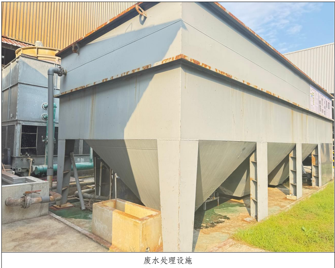
图 4-2 废水处理设施照片
