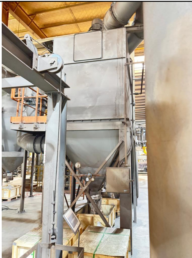
抛丸废气处理设施
