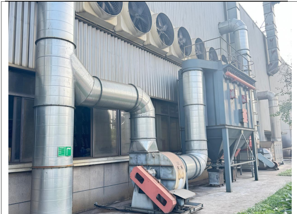
喷塑废气处理设施
