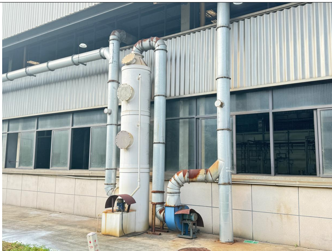
浸漆废气处理设施
