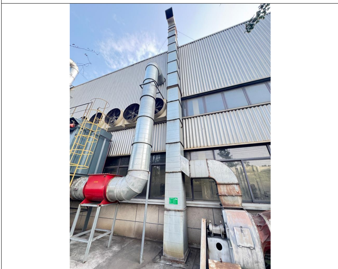
固化废气排放口
